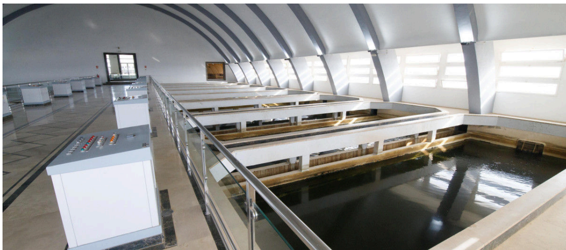
Estación depuradora de aguas de Emacsa en Villa Azul (Córdoba)La Voz
